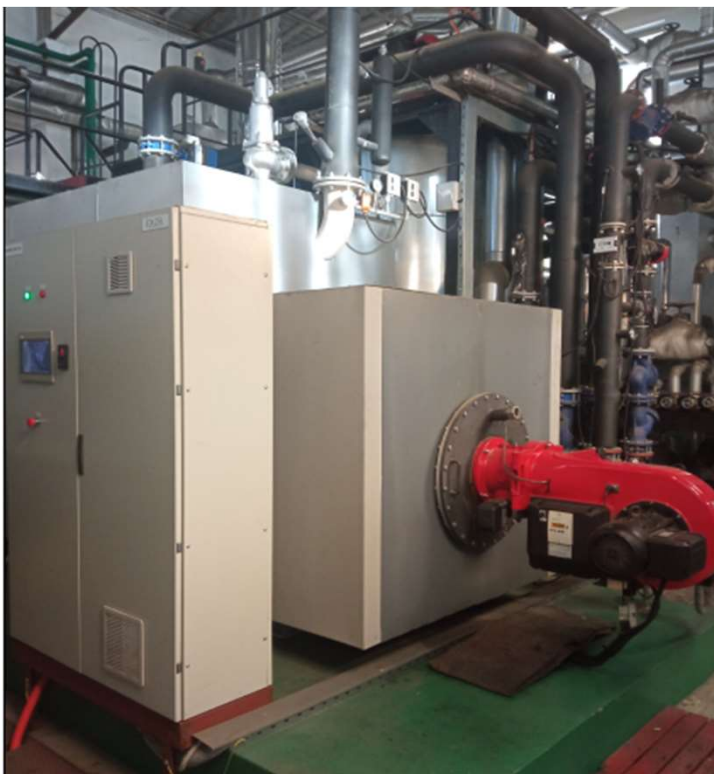
Centralna kotlovnica-toplovodni kotao
